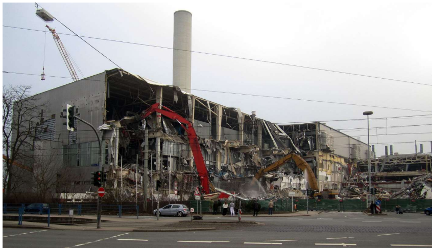
Fig. 8: Cs chirp. Abriss der Lackiererei des Opel Werks I in Bochum, Ende März 2015 von der Wittener Straße aus gesehen. 2015. Bochum. Photograph. Wikimedia Commons . Web. 17 Mar. 2016.
